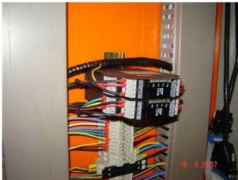
PLC - RELÉ DE SEGURANÇA NÍVEL 4
